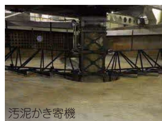
水処理設備の更新
